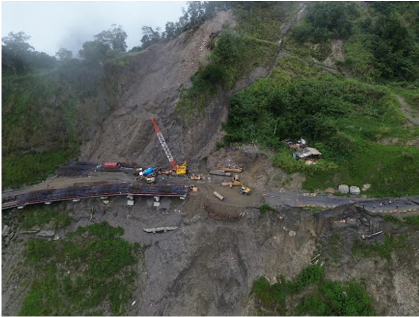
圖 1、114 年 7 月藤枝林道 18.2 K 處崩塌災後影像（向北拍攝；影像來源：國立成功大學防災研究中心，20250712）。
