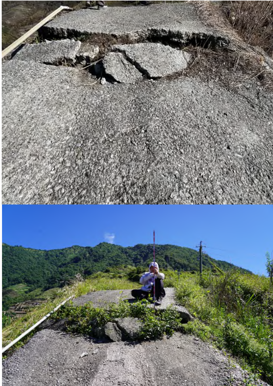
圖 15、大規模崩塌冠部水泥路面斷差處，位於圖 12-B 處。上圖為 113 年 12 月 19 日拍攝，下圖為本次調查(114 年 8 月 7 日)拍攝。裂隙垂直斷差約 30 公分、裂隙寬約 90 公分。
