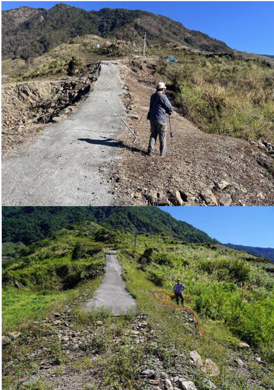
圖 14、靜觀大規模崩塌冠部，位於圖 12-A 處。上圖為 113 年 12 月 19 日拍攝，下圖為本次調查(114 年 8 月 7 日)拍攝。可見於下圖紅線標註處疑小型新生崩崖發生，陷落方向為東南方。(向東北方拍攝)
