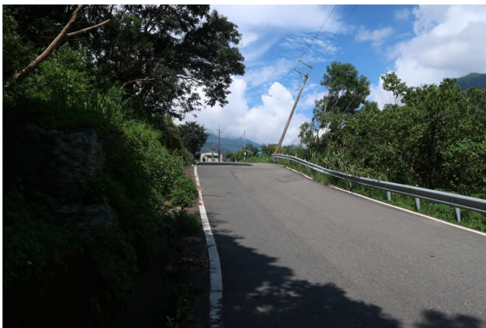
圖 11、廬山北坡滑動體的東側邊界、台 14 線 92 公里處原 112 年崩塌處現況，本次強降雨事件後並無崩塌現象，但該處仍持續有滑動現象導致道路破裂修補及電桿傾斜。(於圖 5-I 處拍攝，拍攝日期 114 年 8 月 6 日)
